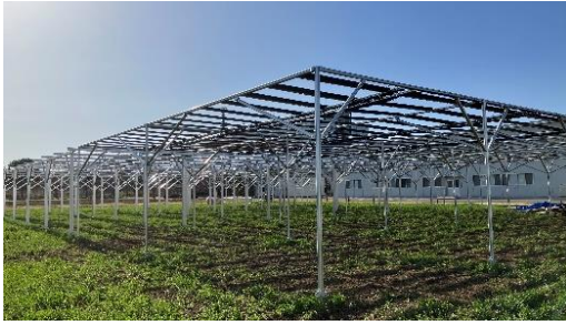
設置架台の全景
