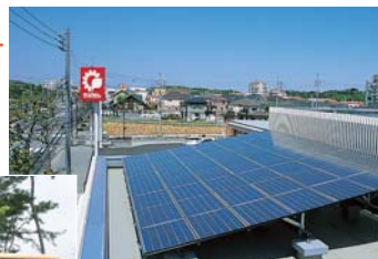
太陽光発電設備 （ちはら台支店）
